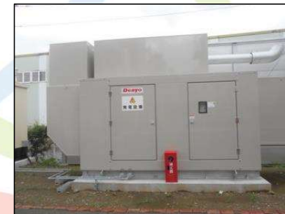
非常用発電機設置
